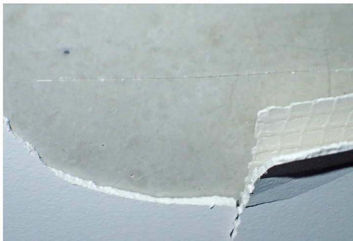
8 Flächige Ablösung der Gipsspachtel von Betonuntergrund.
