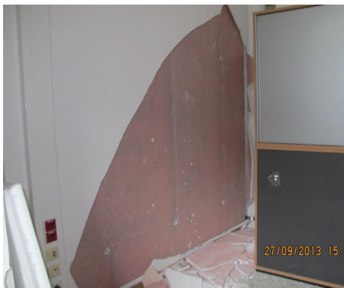
11 Betonwand mit Haftbrücke (rot eingefärbt), am Boden abgestürzte Putzteile mit Haftbrücke.
